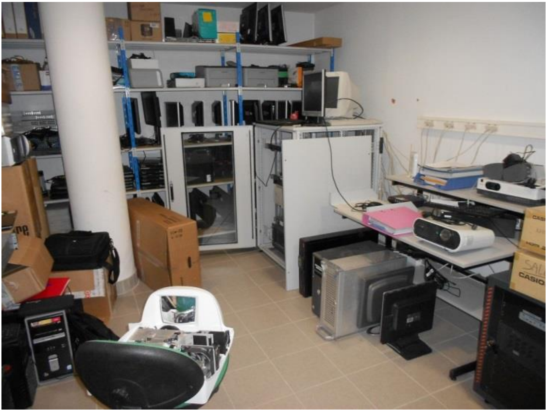
Salle du serveur le 24/01/18 à 18h05
